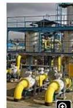
Un impianto per il gas
