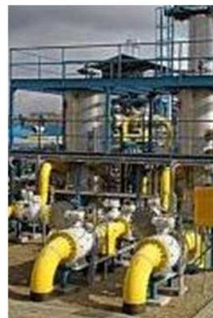
Un impianto per il gas
