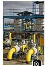
Un impianto per il gas
